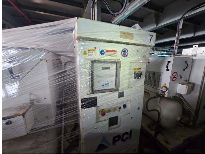
Oxygen generator x 2 nos.
