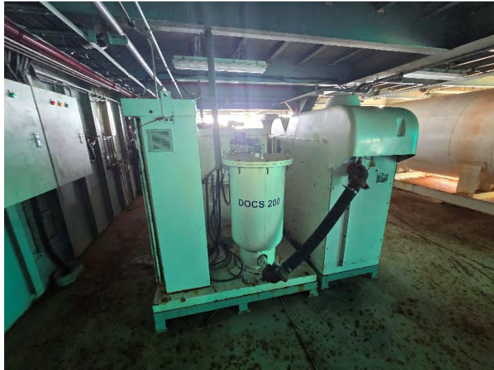
Oxygen generator x 2 nos.
